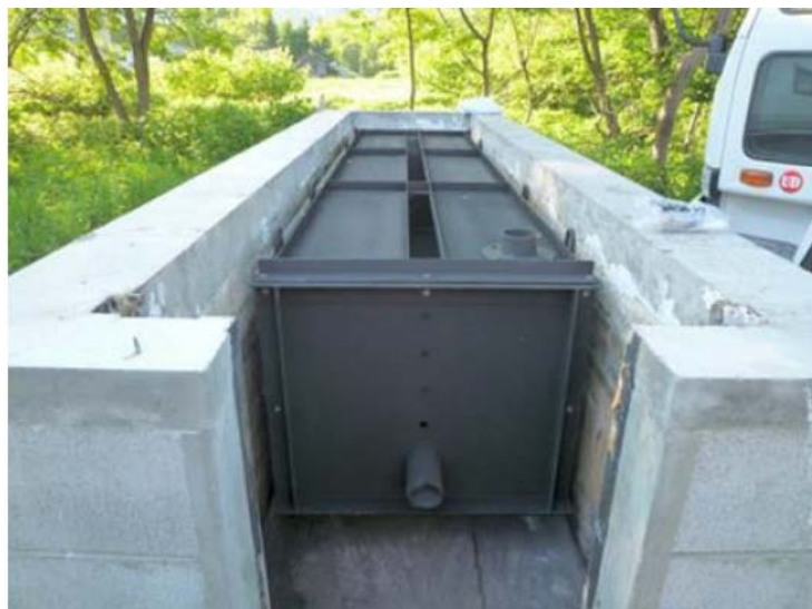
(試験炉内の鋼製タンク)
