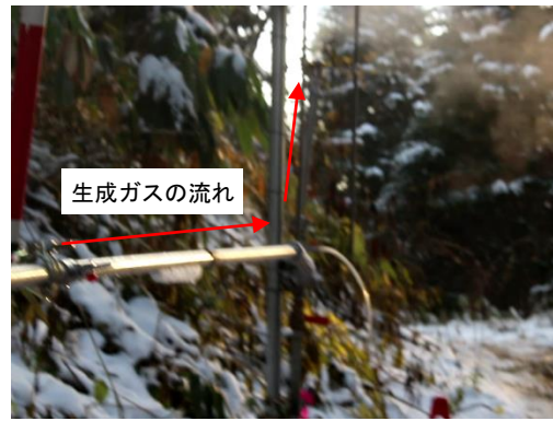
⑤生成ガス配管
