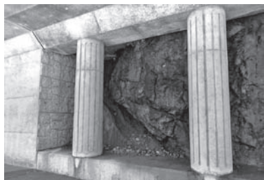
5 ひとまたぎ覆道 ふくどう これが断層！大地が動いた証しを間近で見ることができます。
